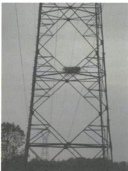
Figure 21 : Nid dans un fût de pylône (RTE)
