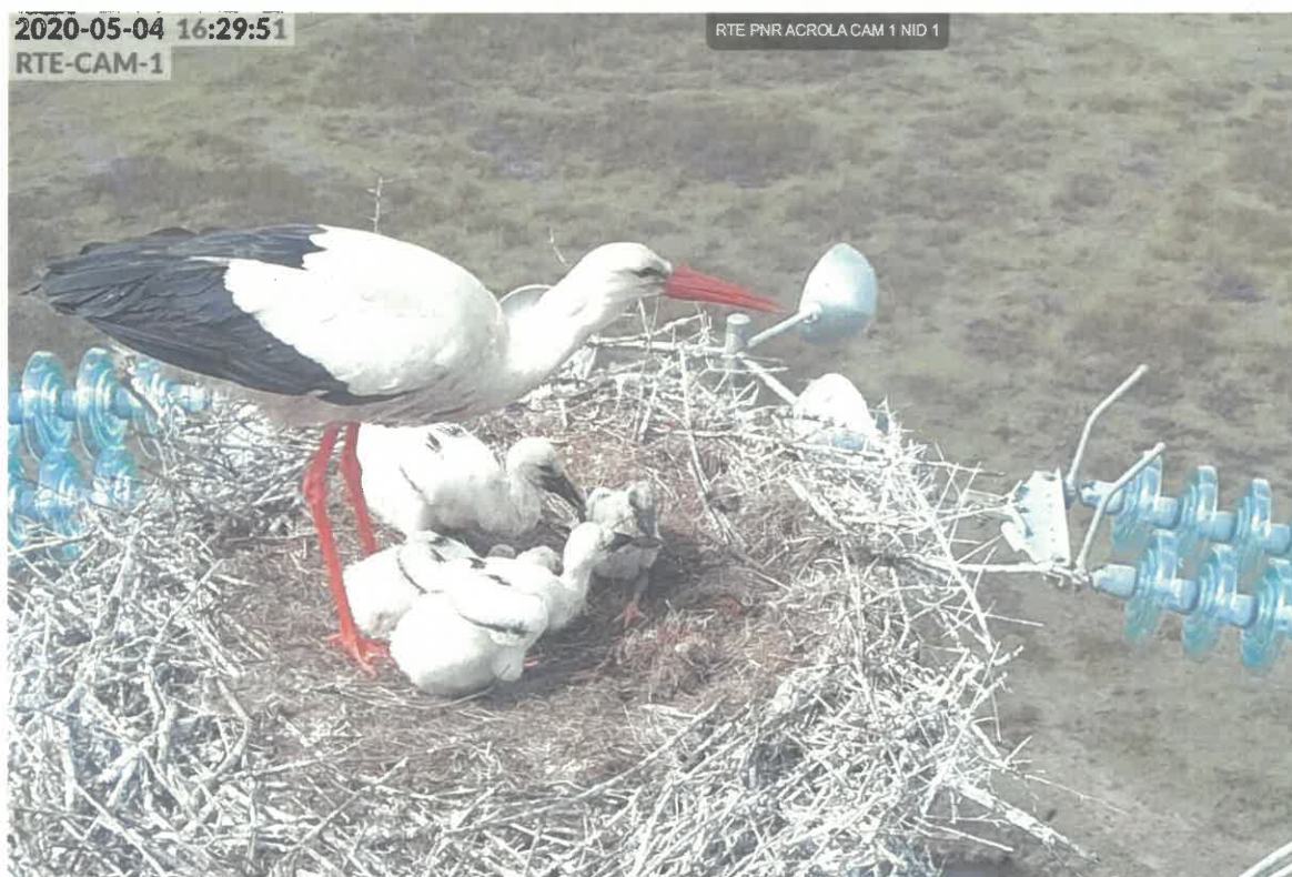
Figure 5 : Caméra sur un pylône haute tension (ligne RTE 63 kV Brivet (GDF)-Donges-Guersac – Z. Brivet) à Montoir-de-Bretagne (ACROLA, RTE & Parc naturel régional de Brière)
